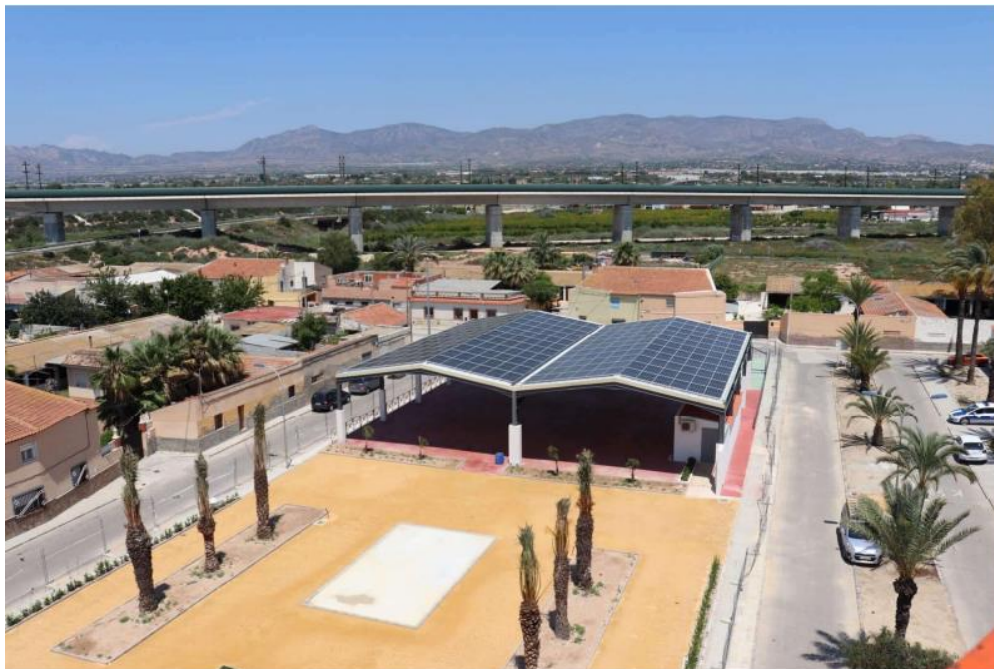
Figura 11. Placas solares en la comunidad energética de Crevillent, Alicante.
