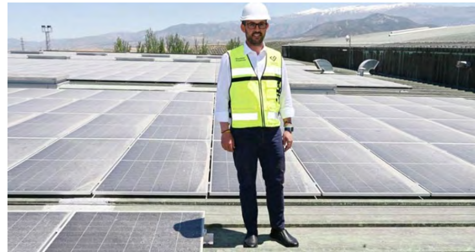
Ilustración 17: Instalación fotovoltaica en la Ecocentral de la Diputación de Granada. Fuente: Diputación de Granada.
