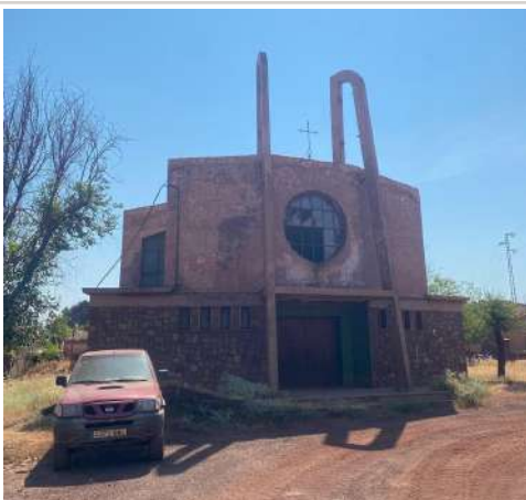
Figura 72. Estado actual de uno de los edificios industriales utilizados como localización musical. Fotografía del autor, 2026.
