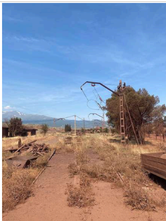
Figura 68. Estado actual de las vías y estructuras ferroviarias. Fotografía del autor, 2026.
