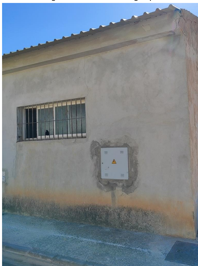
Imagen 26. Suministro de agua y luz
