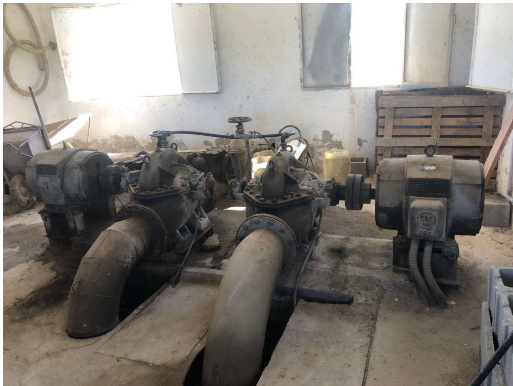
Figura 6. Sistema de bombeo de una de las estaciones.
