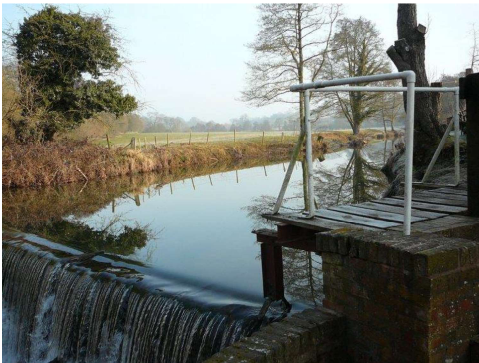
Figura 14. Presa donde se ubica la central hidroeléctrica.
