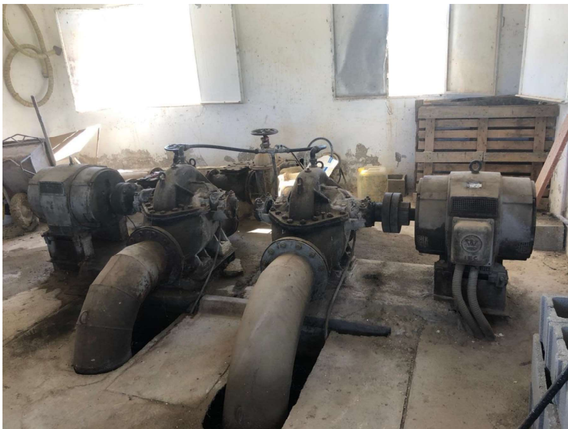
Figura 23. Motores de una de las estaciones.
