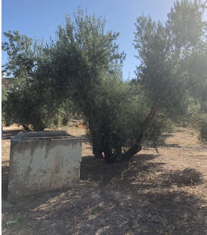
Figura 19. Chimenea reductora de presión.
